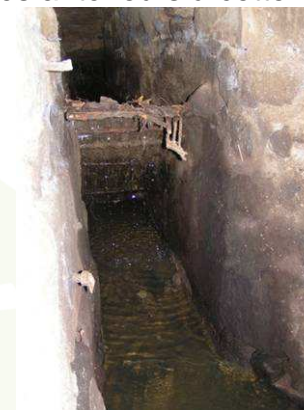
Rampe à supprimer au Moulin de la Tréлитиèrre
