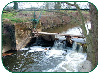
Clapet percé sur l'Argos
