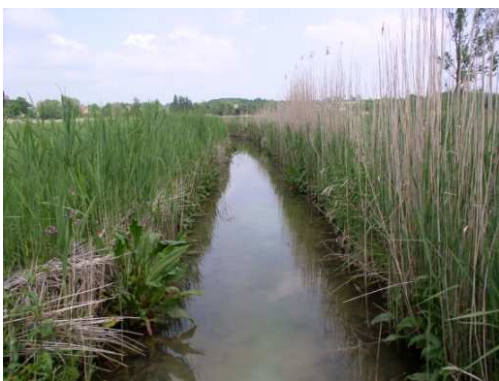
Exemple de cours d'eau dégradé prenant l'aspect de fossé
