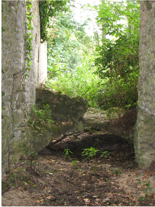
Photo 1 : entrée et canal d'amené du moulin de Grenet (commune d'Airvault – 79600), (source SMVT – Olivier CONSTANTIN).
