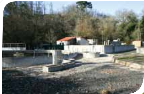
Photographie 21 : station d'épuration
