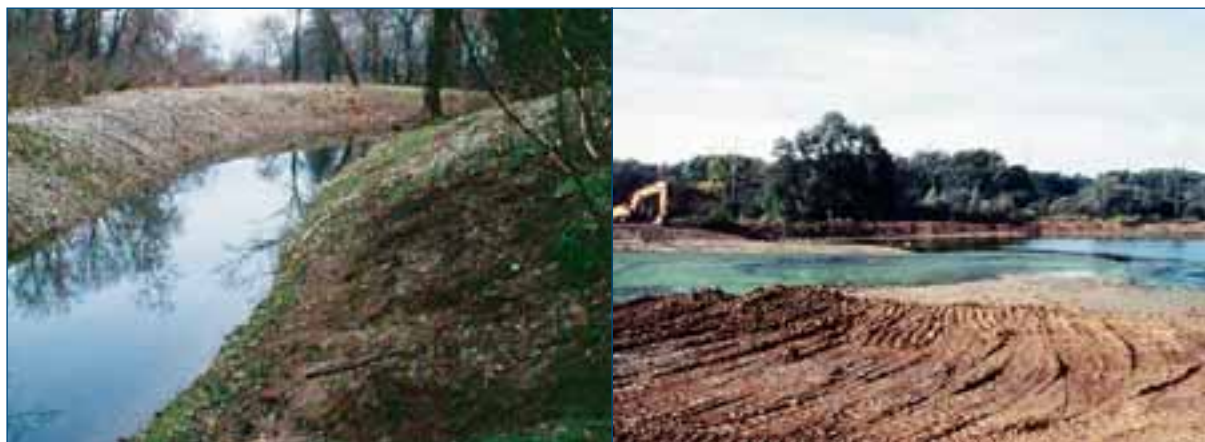
↑ Figure 31 : Terrassements de berges d'annexes hydrauliques en pente élevée à gauche, offrant peu de place à la diversité biologique et variations de profils beaucoup plus doux à droite, devant permettre la reconstitution de séries végétales adaptées. ≡
