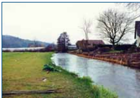
↑ Figure 82 : (27.02.07) Aménagement encore en cours à Croville avec suppression des merlons, recharge alluviale, adoucissement de la berge gauche au droit des parcelles agricoles et techniques du génie végétal (ici alternance de tressages de saules et de fascines d'hélophytes) en rive droite . ≈
