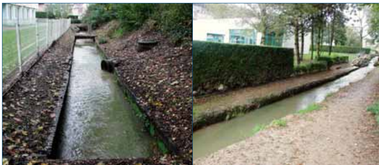
↑ Figure 65 : Etat du Bolbec avant sa restauration. ≡
