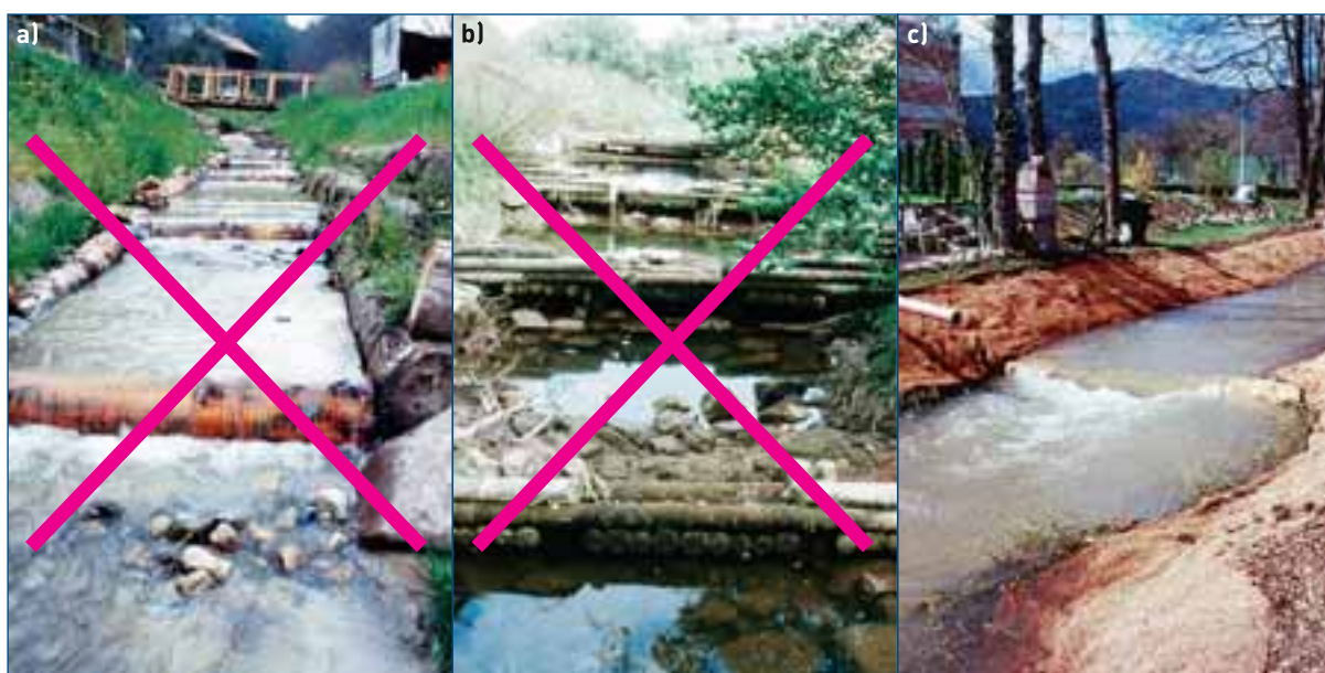
↑ Figure 22 : a) et b) Seuils en rondins de bois (à déconseiller). c) Seuil en enrochement (à conseiller). En effet, selon nous, la mise en place de seuils en enrochements permet un rendu plus respectueux des processus naturels, en limitant la largeur de la lame d'eau. 🌊
