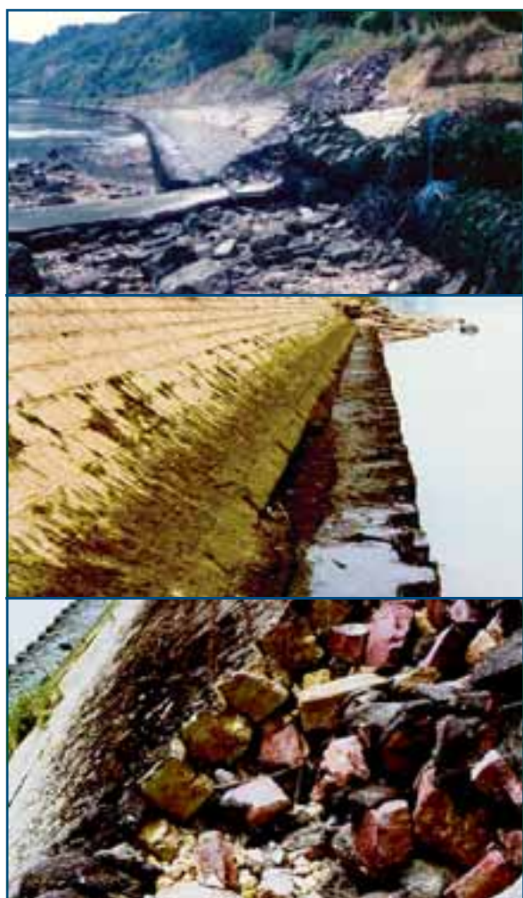
↑ Figure 69 : Exemple de protections de berges de Seine avec palplanches et perrés puis détail de détérioration des perrés. ≡
