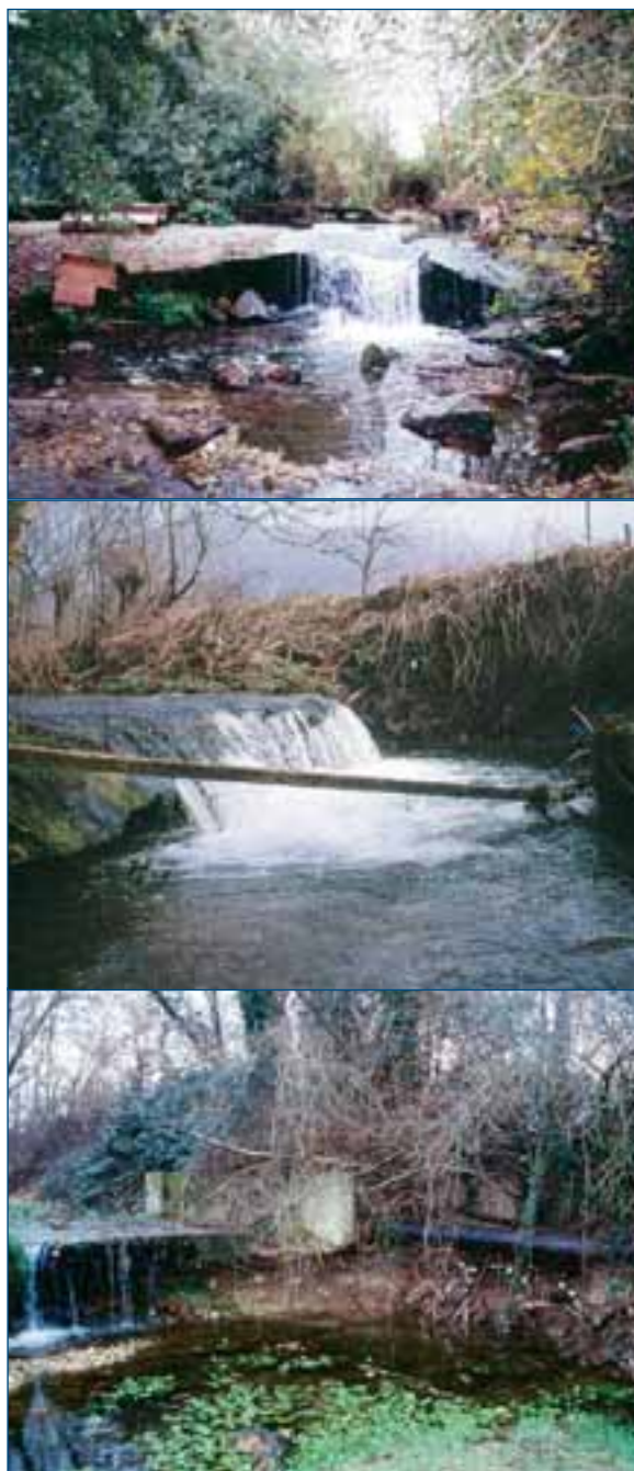
↑ Figure 23 : Exemples d'affouillements en pied de seuils, rendant les ouvrages infranchissables par la faune piscicole. 🌊
