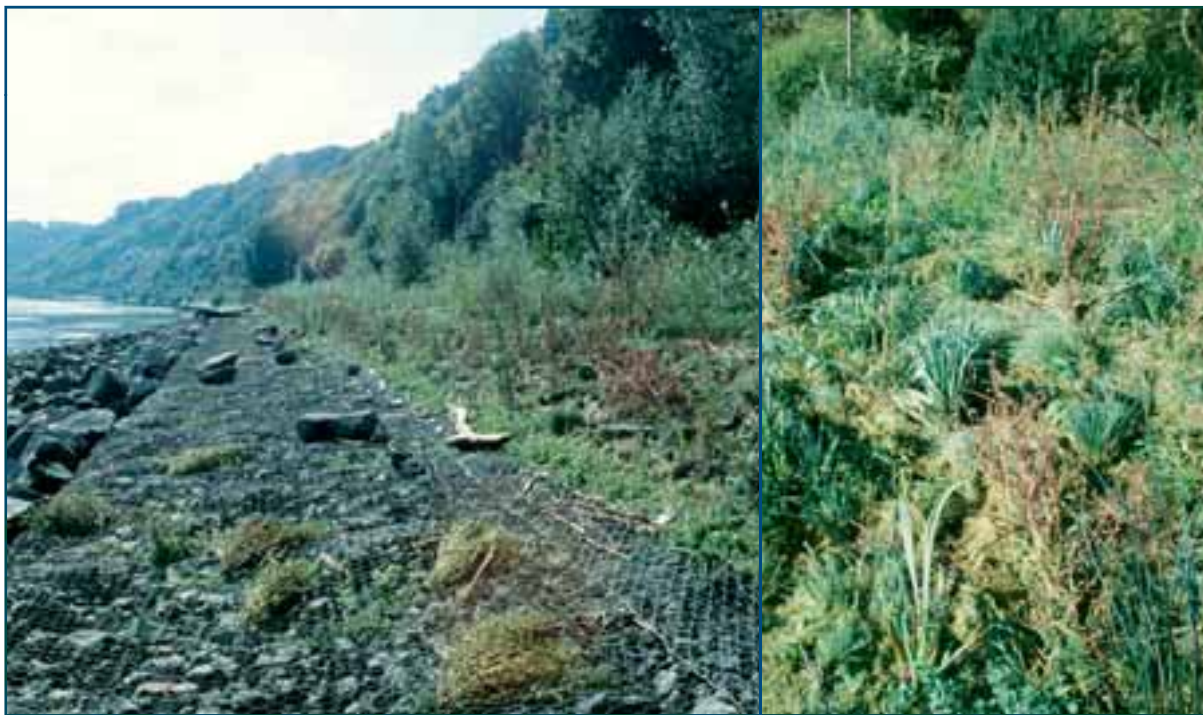
↑ Figure 76 : Vue d'ensemble et de détail du site de travaux un an après sa réalisation. ≍
