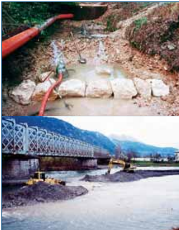
↑ Figure 25 : Exemple de dérivation des eaux sur un petit cours d'eau en haut et batardeaux en graviers sur un plus grand cours d'eau en bas. ≡
