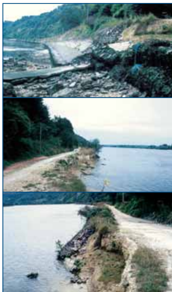
↑ Figure 70 : (18.08.00) Etat initial de l'érosion avant les travaux de réfection de la berge, juste à l'aval de perrés existants maintenus et d'anciens gabions détruits par les contraintes du site. ≡
