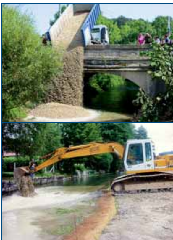
↑ Figure 81 : Photos de Christophe Lebas, technicien de rivière à l'ASA. Remblaiement de « charge solide » dans le cours d'eau. ≈
