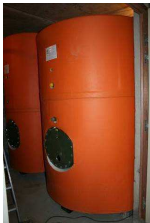
Ballons d'eau chaude
