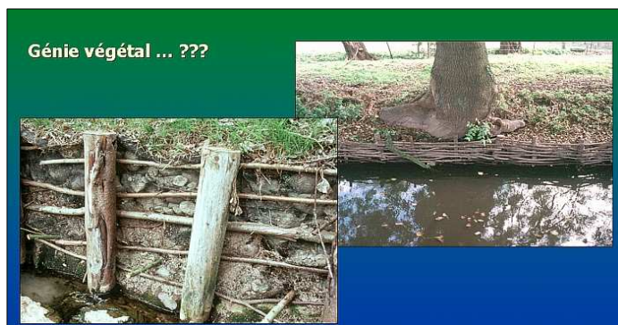
Figure 12 : Très mauvaise application des principes du génie végétal. On est très éloigné des modèles naturels
