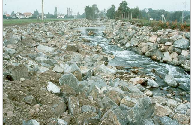
Figure 6 : Destruction d'un lit naturel au profit d'énormes enrochements monstrueux. Essayer de recréer un cours d'eau naturel à partir de cela est impossible sans tout enlever et tout refaire
