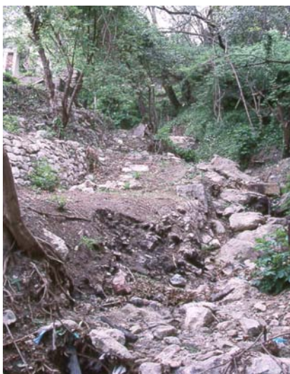
Figure 16 : Détail du lit nettoyé montrant les effets de l'érosion et de la dégradation des terrasses et des murs. Le torrent manque souvent d'eau et les crues sont aussi subites que très violentes (1999)
