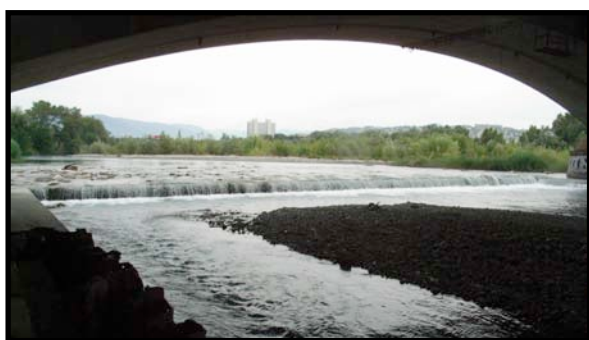
Figure 65 : seuil du pont Napoléon sur le Var (MRM)
