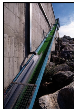
Figure 17 : rampes de reptation sur l'usine écluse de Beaucaire sur le Rhône (MRM)
