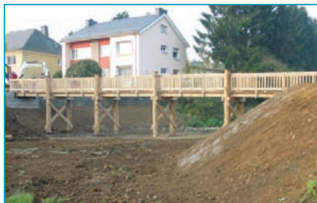
Aménagement d'un pont sur pilotis sur la Chiers qui s'adapte écologiquement et hydrauliquement au milieu humide.
