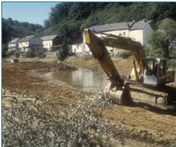
Travaux de rehaussement du fond et d'élargissement du lit de l'Alzette à Hesperange.
