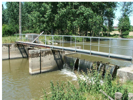
Figure 2 : Clapet de l'Elunière sur la Sèvre amont (source : IIBSN)
