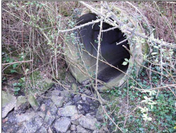
La canalisation de diamètre 1 200 mm (exutoire des eaux issues de la STEP de l'ancien site Heuliez)
