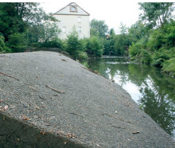
Le barrage fait obstacle à la circulation de l'eau, des espèces et des sédiments. (site de Grangeard sur la Moine à Cholet).
