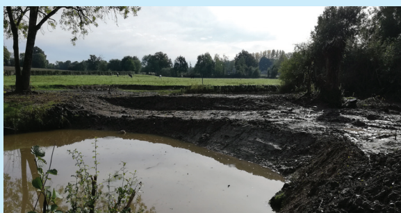
Effacement de l'ouvrage hydraulique du Terrier situé sur la Sèvre nantaise, au Gué du Beau, à Saint-André-sur-Sèvre (79)
