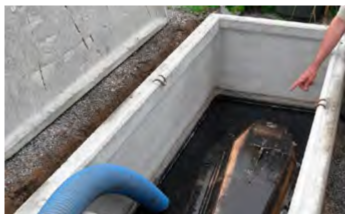
1 - L'eau est remontée dans les caveaux en béton de la partie récente de ce cimetière du nord de la France, entraînant plusieurs plaintes de la part de familles relayées dans la presse locale. © La Voix du Nord 2016
