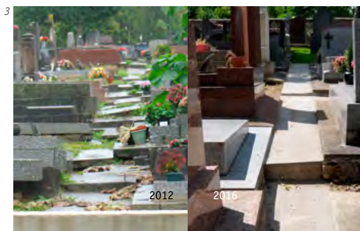
3 - En 2012, les semelles des monuments, non planes et non jointives, ne permettent pas de circuler avec sécurité dans certaines allées secondaires. 4 - En 2016, un travail de reprise des semelles et de création de cheminement en béton a été mené. Cimetière des Gonards à Versailles (78) © P&C - Sandrine LARRAMENDY 2016
